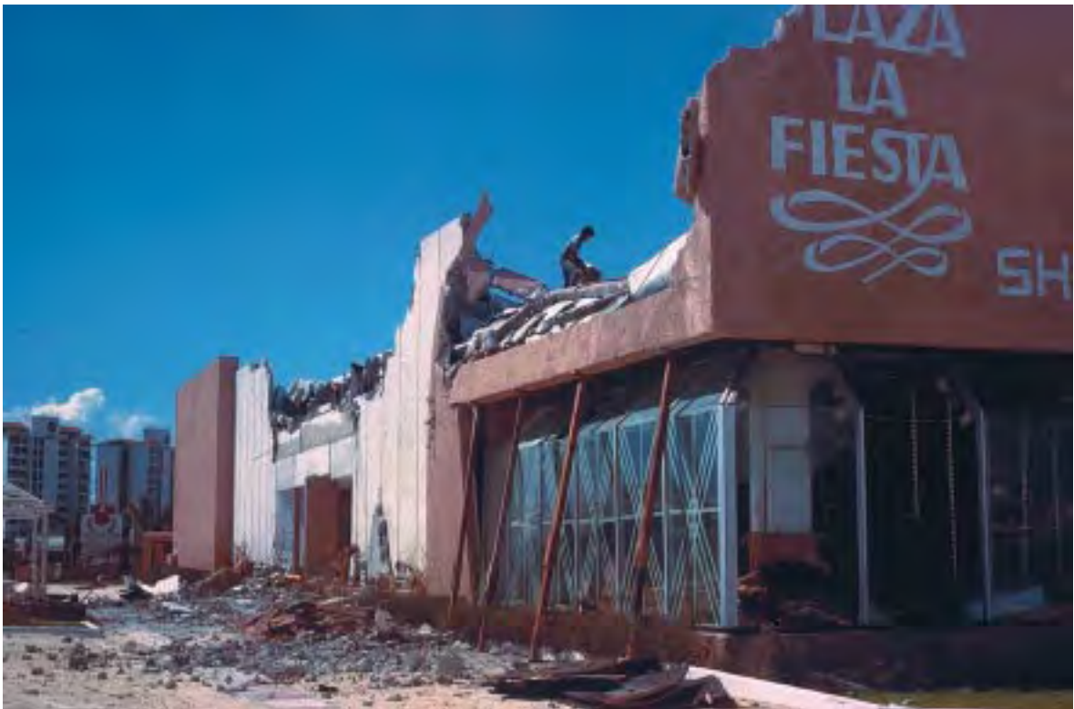
Figura 92. Daños causados por el huracán Gilbert en Cancún
