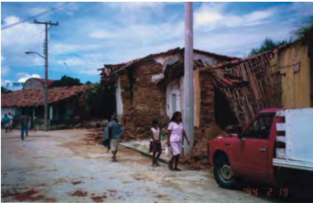
Figura 27. Daños típicos en construcciones de adobe
