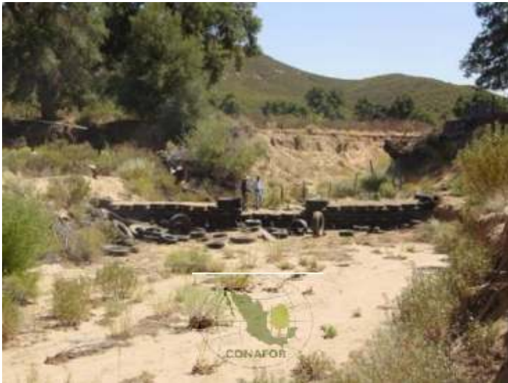
Figura 79. Presa de llantas
