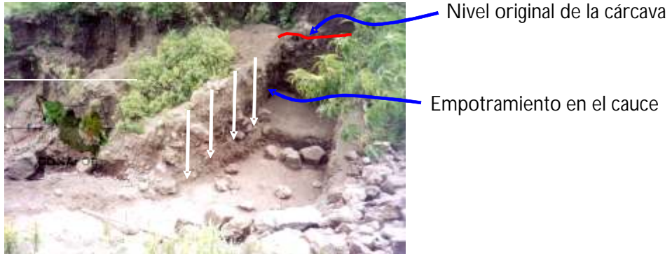
Figura 87. Empotramiento en el cauce
