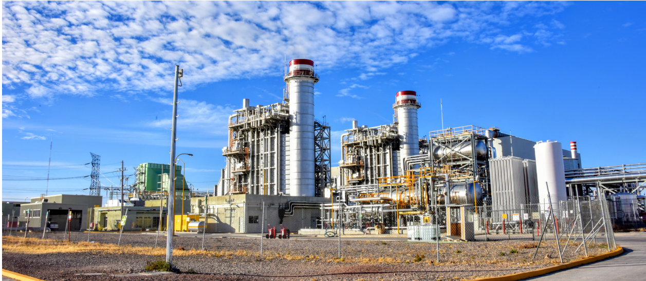
Central de ciclo combinado. Agua Prieta, Sonora. Comisión Federal de Electricidad.
