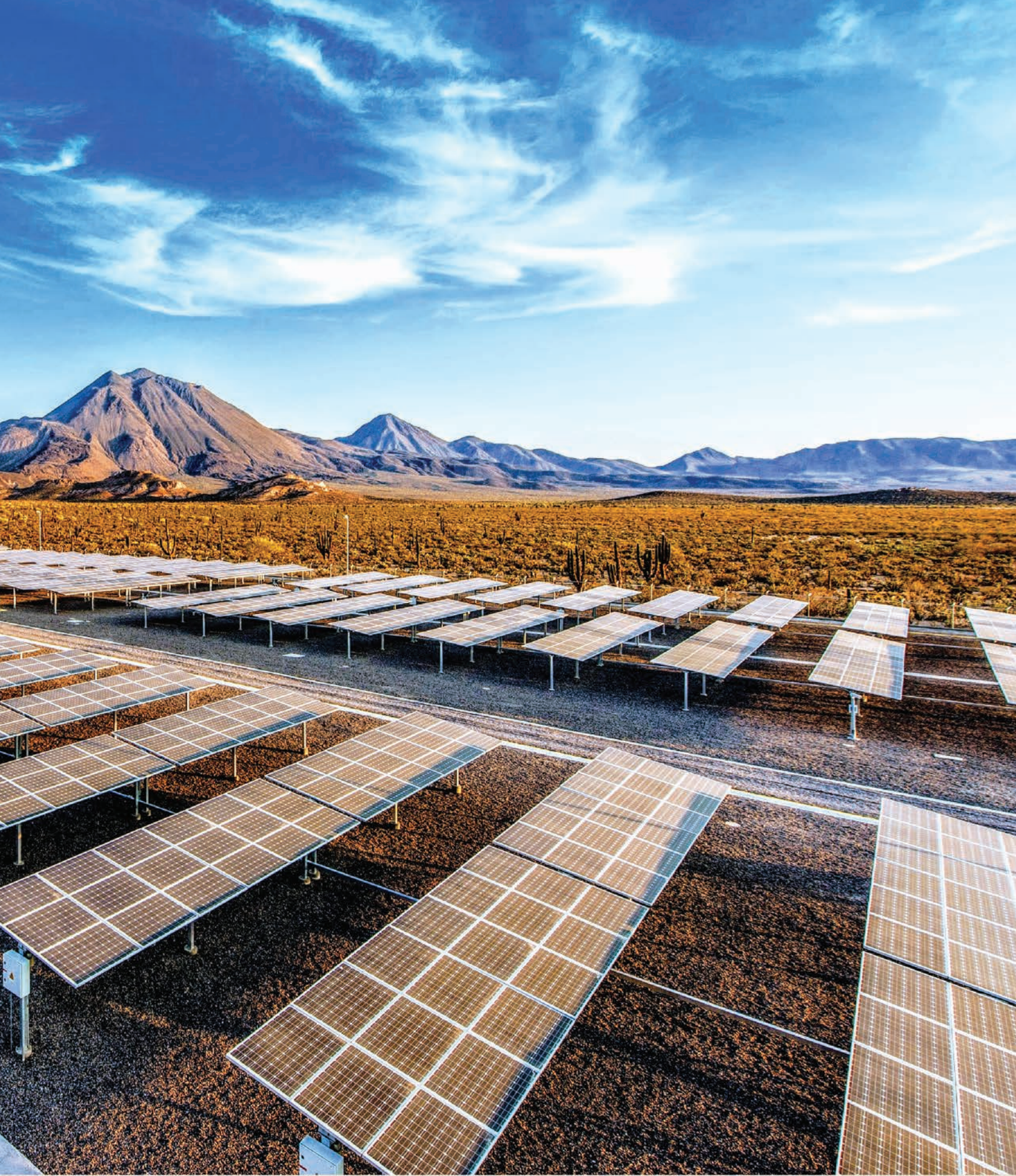
Central fotovoltaica, Santa Rosalía, Baja California Sur. Comisión Federal de Electricidad.
