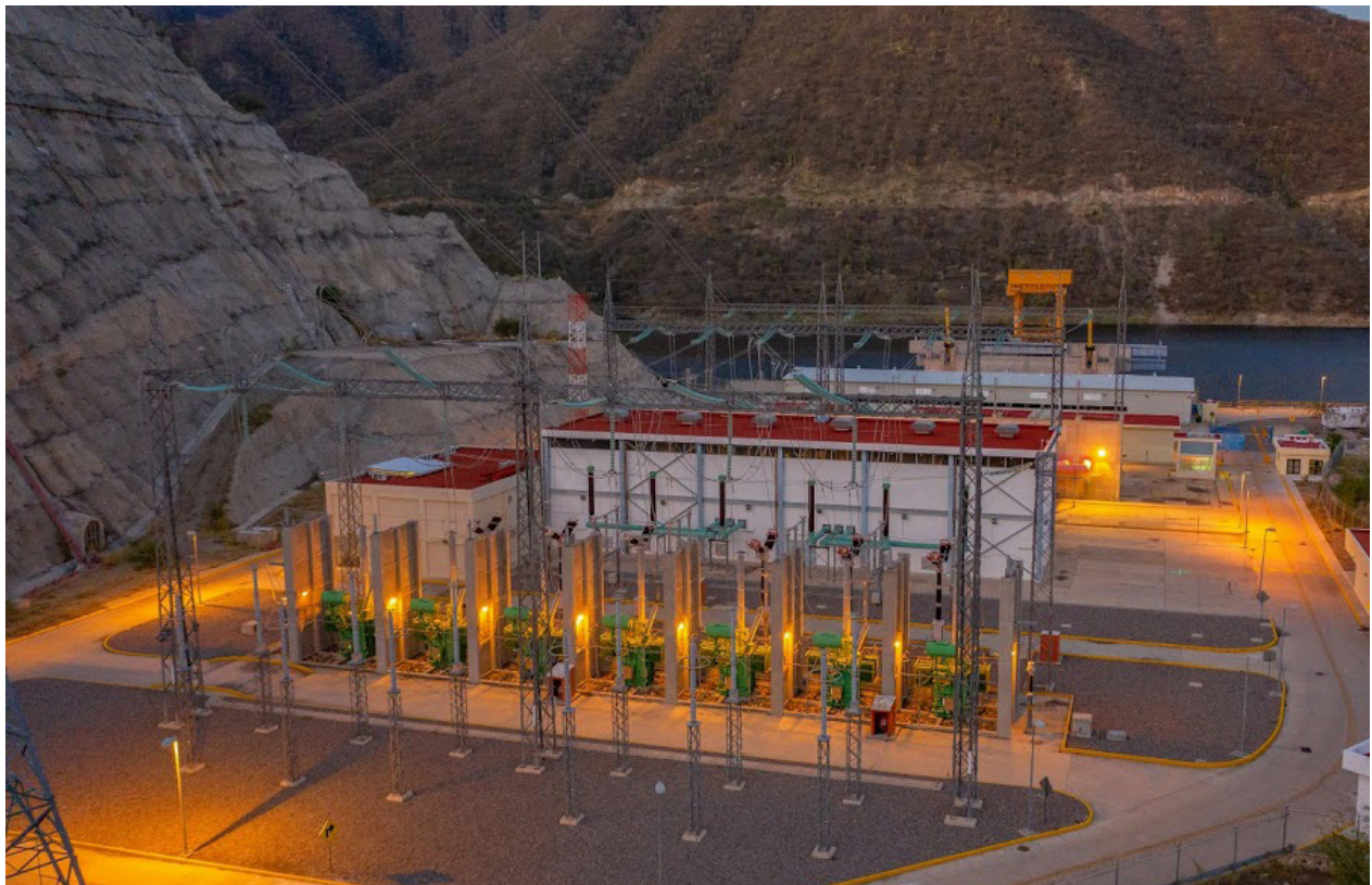
Subestación de transmisión. La Yesca, Nayarit. Comisión Federal de Electricidad.
