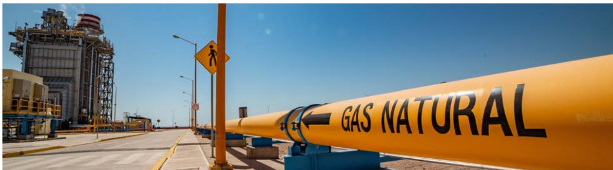
Central de Gasoductos , Empalme, Sonora Comisión Federal de Electricidad.
