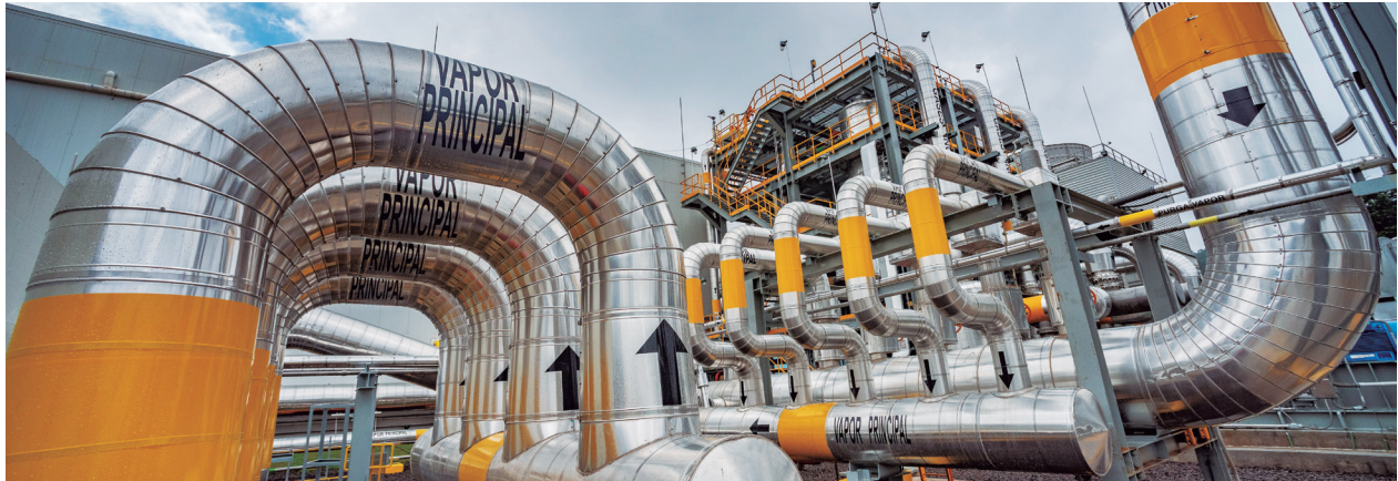
Central geotérmica. Los Azufres, Ciudad Hidalgo, Michoacán. Comisión Federal de Electricidad.
