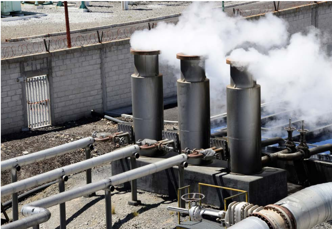
Central geotérmica, Los Humeros, Municipio de Chignautla, Puebla. Comisión Federal de Electricidad.
